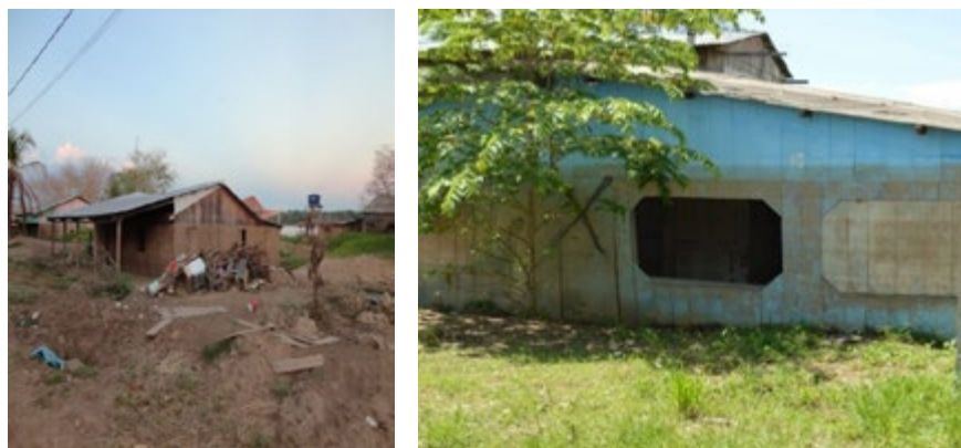
Figura 34 – Registro dos efeitos causados pela enchente na comunidade de São Carlos do Jamari, Porto Velho/RO.
